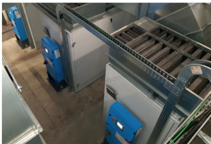
Hochdruckverdichter von BAUER versorgen die Pressen mit dem nötigen Druck.
