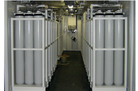
Mächtige Speicherbatterien sorgen für permanente Verfügbarkeit an Atemluft.
