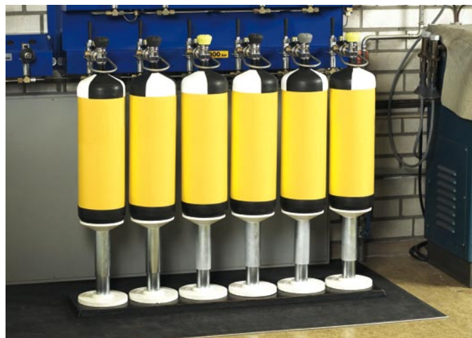
Adaptateurs pour l'air respirable sur une rampe de remplissage
