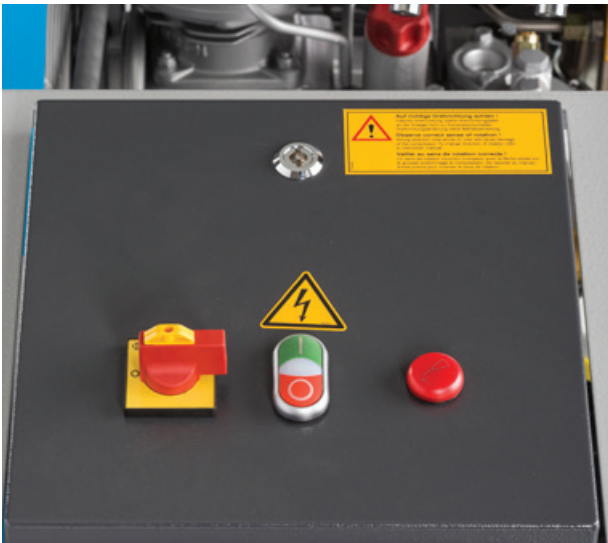
Kompressorsteuerung des MARINER, mit Hauptschalter, Ein- und Ausschalter sowie Meldeleuchte für Ölstands-/Drehrichtungskontrolle
