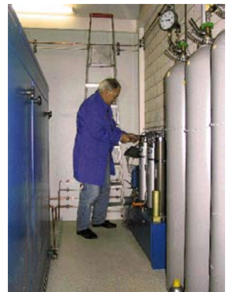
Kompressorraum einer Helium-Rückgewinnungsanlage
