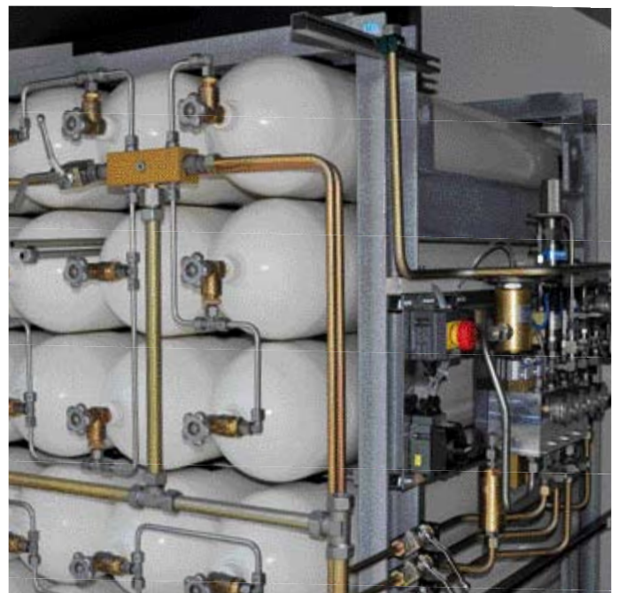
B2000 Speicherbank als Indoorinstallation
